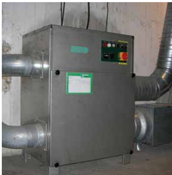
Liljeholmsbronns inre skyddas mot korrosion med hjälp av DST-avfuktare.
