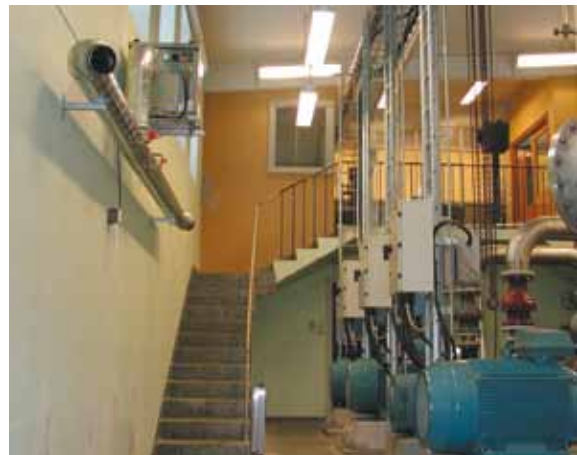
Installerad DR-031C i vattenverk i Sverige.
