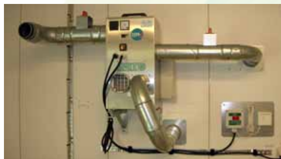
DR-010B med DSTs hygrostat EH-4 kontrollerar fukten i tryckstegringsstation.
