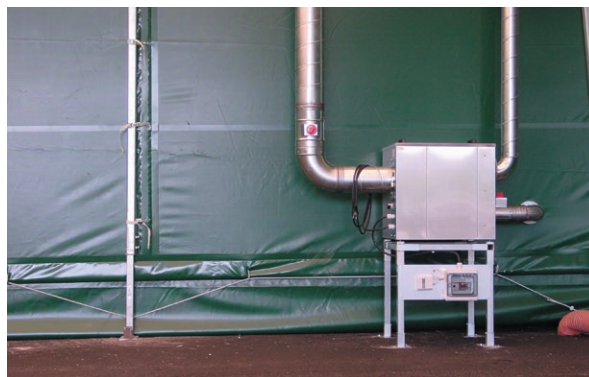
En installerad DST DR-40 avfuktare
