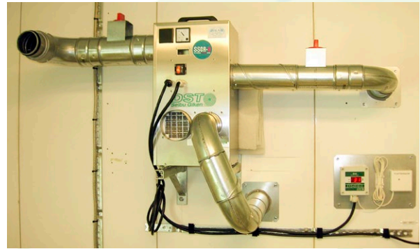
DR-010B med DSTs hygroskop EH-4 kontrollerar fukten i tryckstegringsstation
