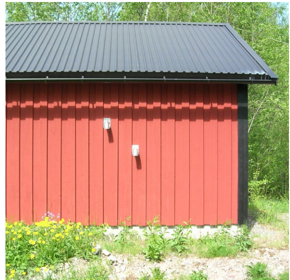
Utanför tryckstegringsstationen leds våluft ut och man tar in regenereringsluft.
