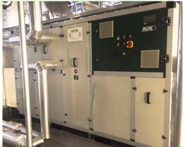
DST RFA-172 avfuktare installerad hos Angel Yeast corporation
